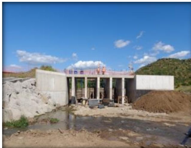
Bocatoma Canal Norte Unificado, barrera frontal.
