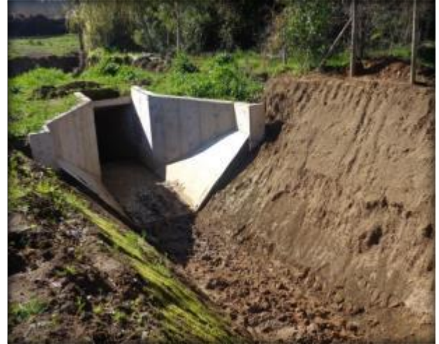
Cámara de salida de Sifón Fortaleza.
